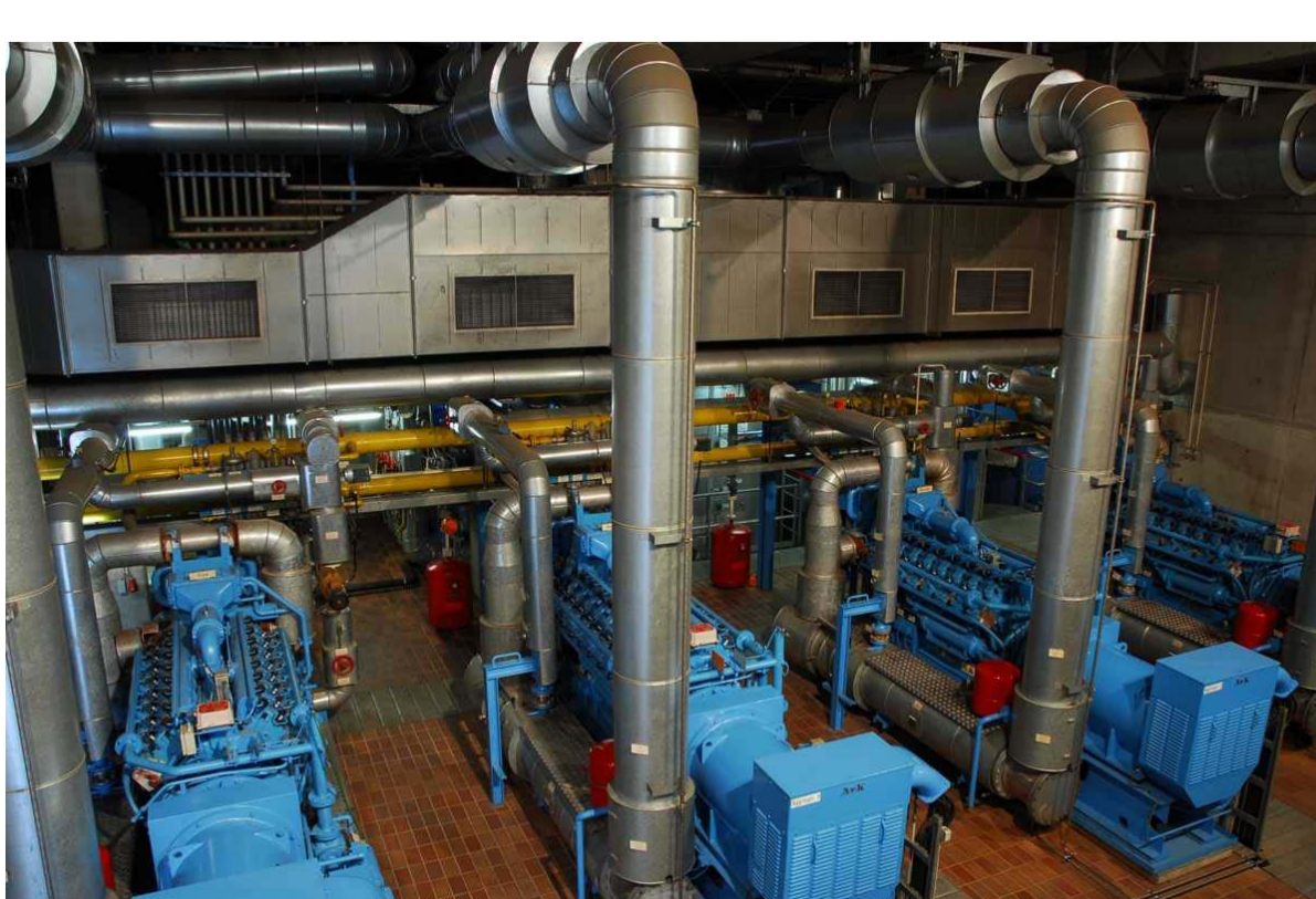
Mauerfeld BHKW Anlagen
