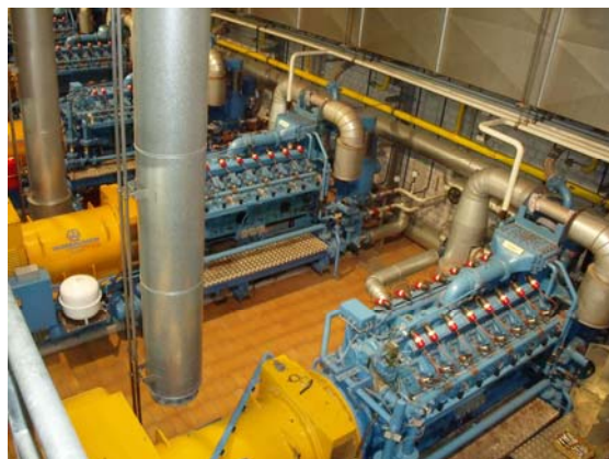
Foto: Innenansicht des BHKW Friesenheim. Die Anlage der badenova WÄRMEPLUS ist eines der im EU-Projekt »MASSIG« ausgearbeiteten Fallbeispiele. ©badenova
